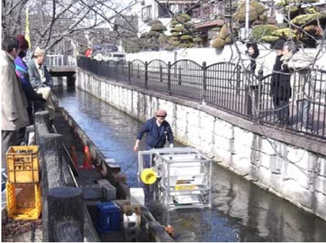
▲長瀬川でのマイクロ水力発電実証実験
